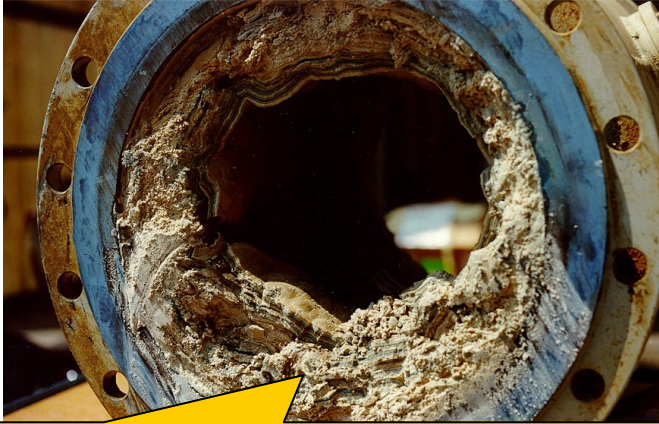
Солевые отложения в измерительном канале не помешали многолетней эксплуатации расходомера MAG-ХМ
