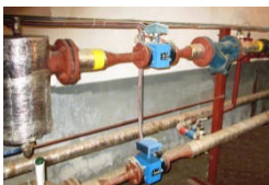
Теплопункт, смонтированный ООО НПФ «Энергоконтроль», г. Иркутск
