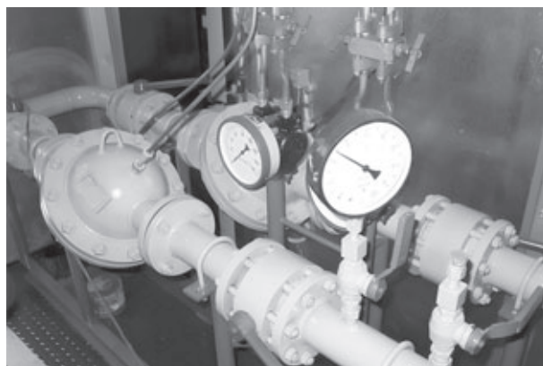
ГАЗОРЕГУЛЯТОРНЫЙ ПУНКТ ГРП.Б. ВИД ВНУТРИ
