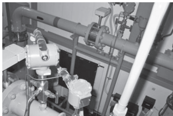
УЗЕЛ УЧЕТА ГАЗА. ВИД ВНУТРИ
