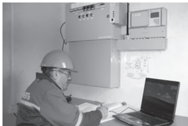
УСТАНОВКА УЗМ.Т. ОПЕРАТОРНАЯ
